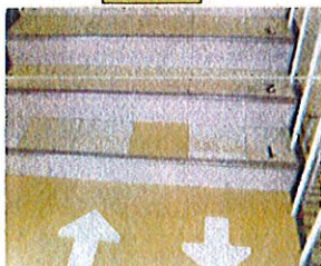
通行区分を定め、事故の多い下3段に段数を示し、注意喚起を図る。
